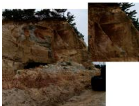
写真1 松川浦大橋東側法面崩壊（3月20日撮影）
