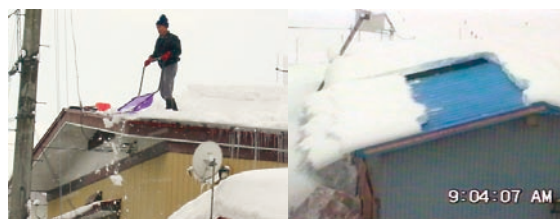
写真1 危険の多い屋根の雪 写真2 屋根雪滑落時の様子 おろし作業
