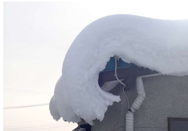
写真5-10 2025/1/5 13:53 青森市内 (雪庇が落雪する危険あり。)
