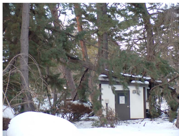
写真5-28 2025/1/13 16:21 弘前公園 (公園内の管理施設も針葉樹(マツ)の 倒木により被害を受けた。)
