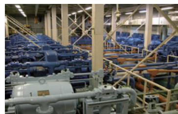
油圧ポンプ Hydraulic pump system
