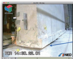
大地震で壁の足元が浮き上がっている。損傷は殆ど見られない。
