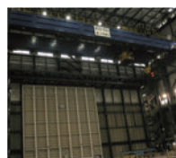
④ 400トン天井クレーン
