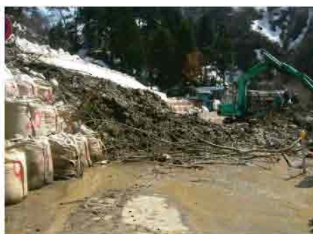
図3 長岡市濁沢町で発生した土砂崩れ
