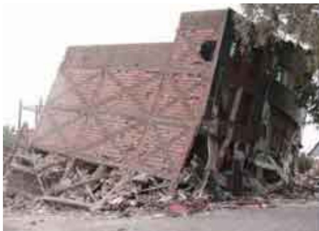
写真2 倒壊した近代建造物
