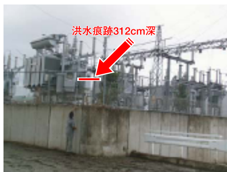
写真2 荒崎地区変電所洪水痕跡
