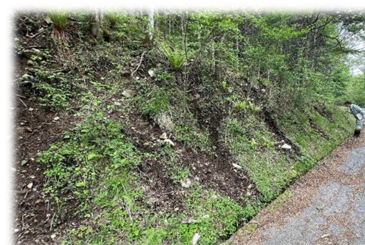
写真1 縦方向での土壌侵食跡
