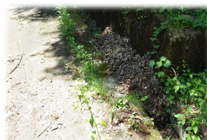
写真2 道路側溝の断面の阻害
