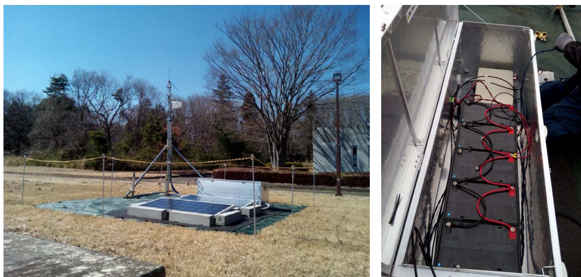
図 2 防災科研構内に設置した LMA センサーの外観。左図が全体、右図が収納箱に格納された受信装置とバッテリー。
